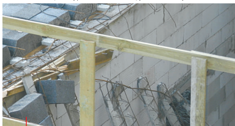
Runęła część stropu, bo prawdopodobnie nie wytrzymały stemple budowlane
