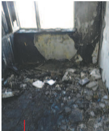
mieszkanie, w którym wybuchł pożar, zostało całkowicie zniszczone
