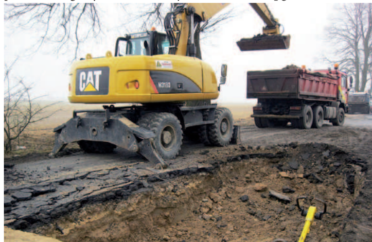
Droga wojewódzka 548 jest w tak fatalnym stanie, że marcu 2011 r. na wysokości miejscowości Czaple ciężarówka zapadła się w asfalt
