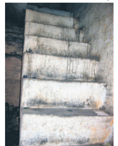
Strome zejście do piwnicy, gdzie znajduje się piec może być niebezpieczne dla 86-letniego mężczyzny
