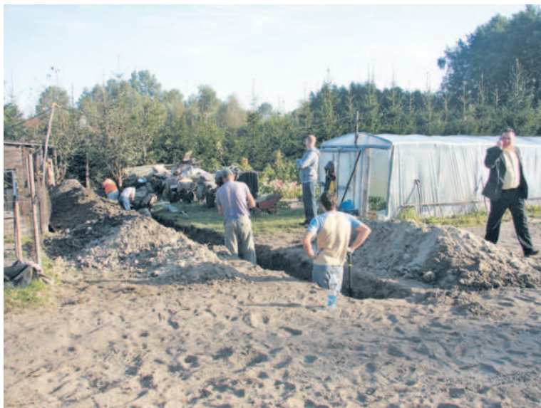
Wodociąg w Płużnicy
