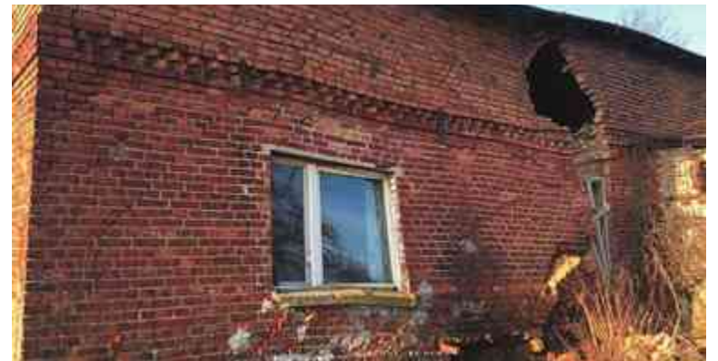
W budynku pękły mury, osunęła się ściana i zawalił sufit (fot. UG Płużnica)
