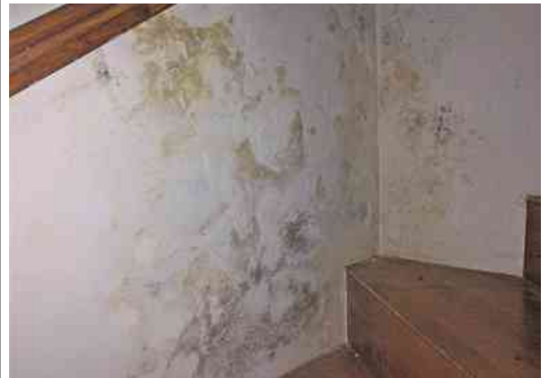
Wilgoć niszczy dom pana Pawłowskiego
