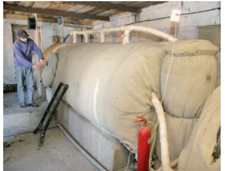
Zdjęcie biogazowni przydomowej w okolicach Zamościa
