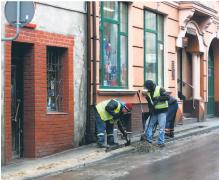
Naruszenia chodnika na ul. 1 Maja wymagała instalacja oświetlenia m.in. na ul. Mickiewicza
