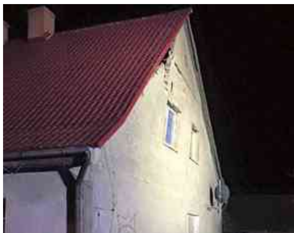
Wybuch naruszył szczytową ścianę budynku
