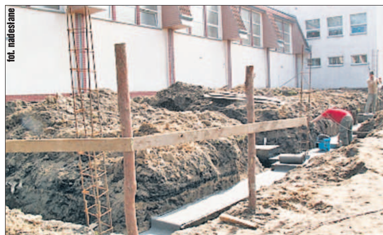
Prace związane z rozbudową gimnazjum w Ryńsku
