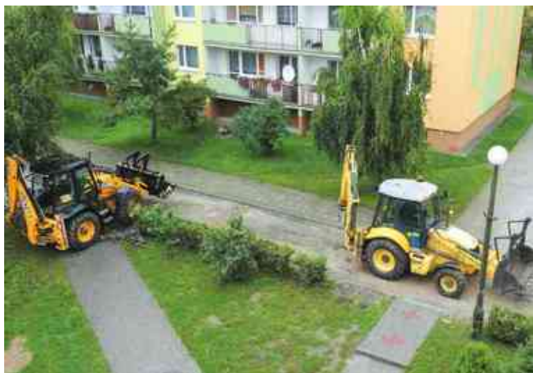
Ciężki sprzęt do prac ziemnych może być mało precyzyjny, dlatego doszło do uszkodzeń kabli zasilających latarnie
