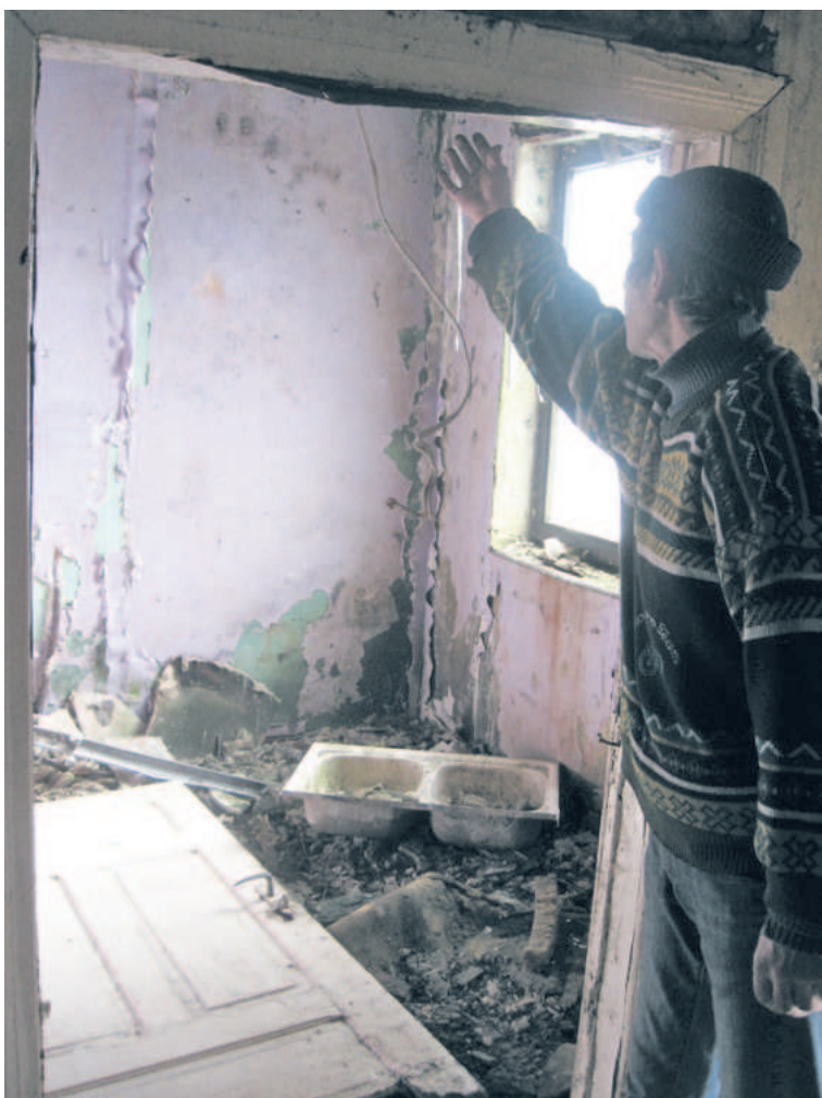
Budynek znajduje się w opłakanym stanie
