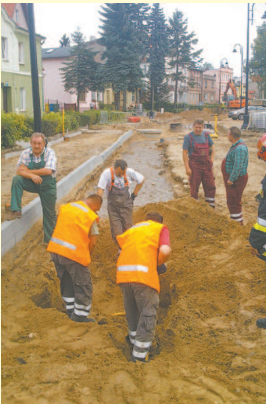
Awaria gazociągu na ul. Wolności w Wąbrzeźnie
