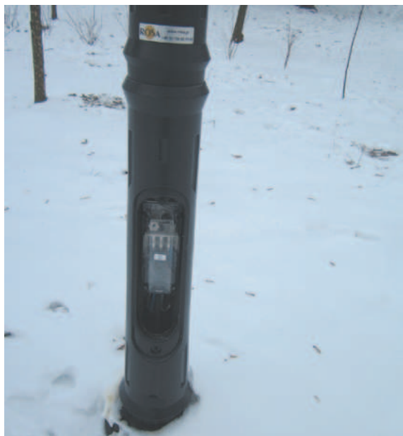
Sprawca bądź sprawcy wyrwali i prawdopodobnie zabrali ze sobą 22 metalowe osłony bezpieczników, uszkadzając przy tym uchwyty mocujące.
