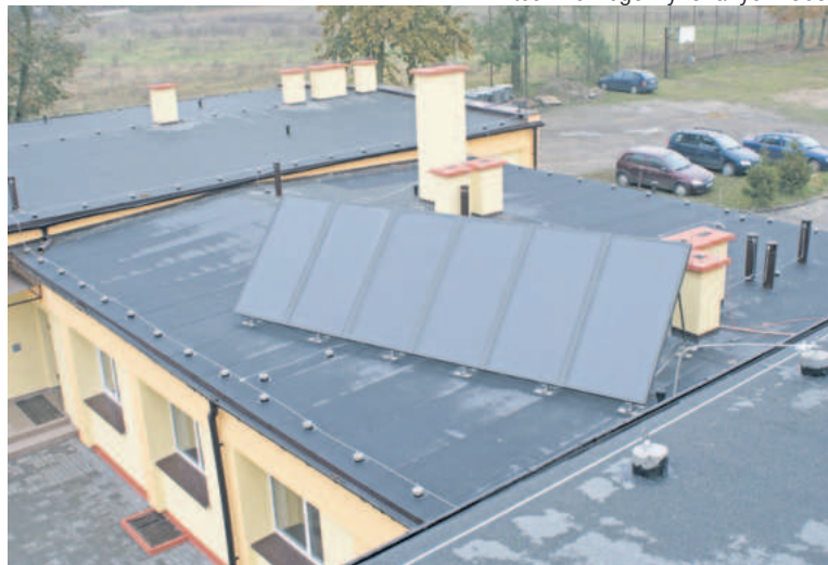
Jeden z zestawów solarnych zamontowanych na dachu szkoły
